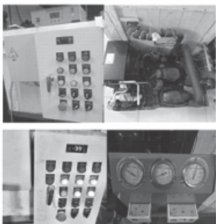
Hình 2.1. Tủ cấp đông gió
