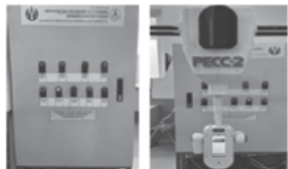
Hình 6. Tủ điện và mô hình robot thực tế
