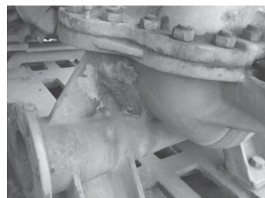
Hình 20. Thân bơm ly tâm bị thủng (đã hàn đắp) tại mỏ than Mạo Khê
